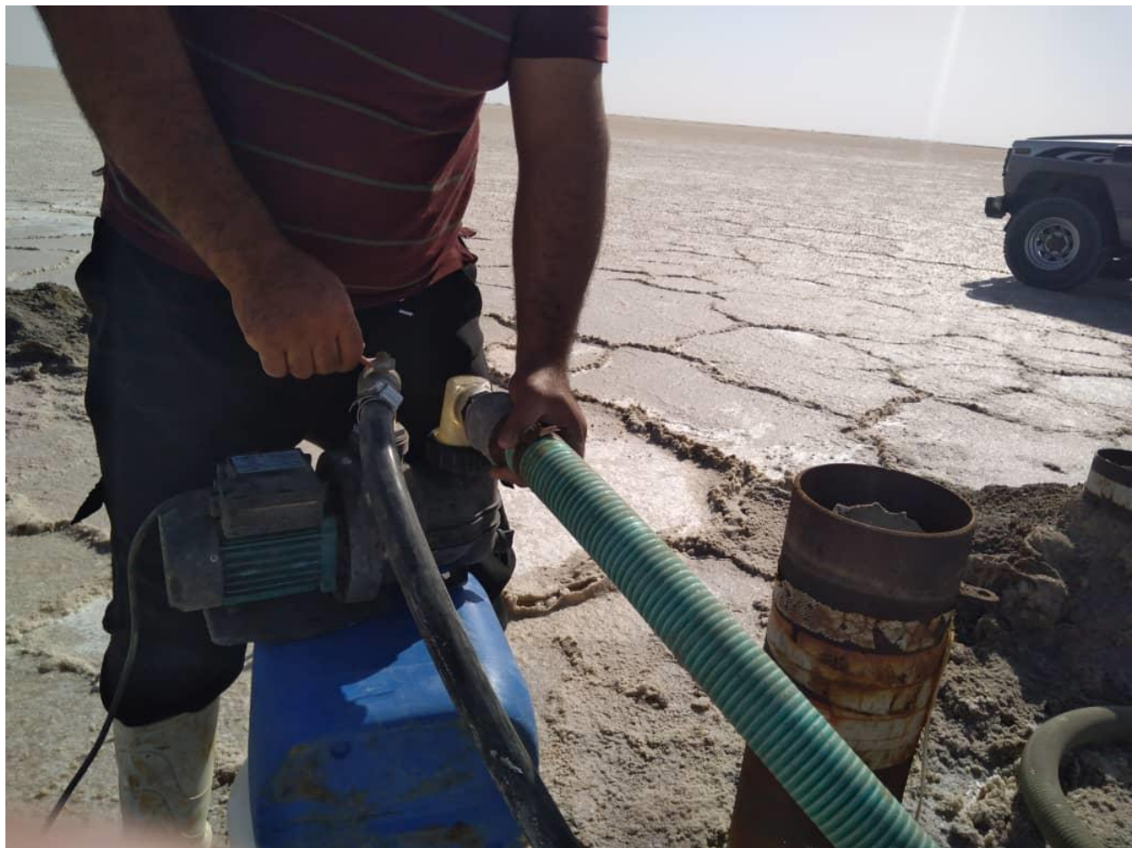
شکل ۳-۳: پمپ در حال آماده‌سازی
